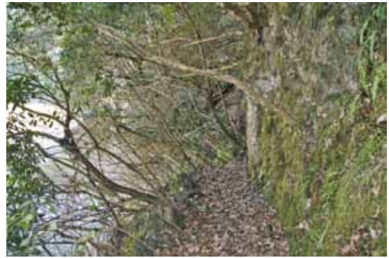
写真 1-28 久野原弁天山の水路跡 昭和28年の大水害により、溝の大半が損壊した
