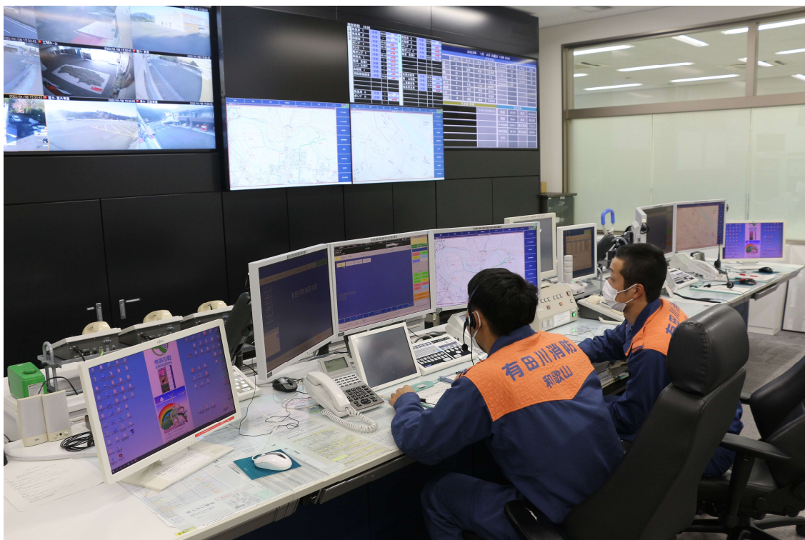
高機能消防指令システム
