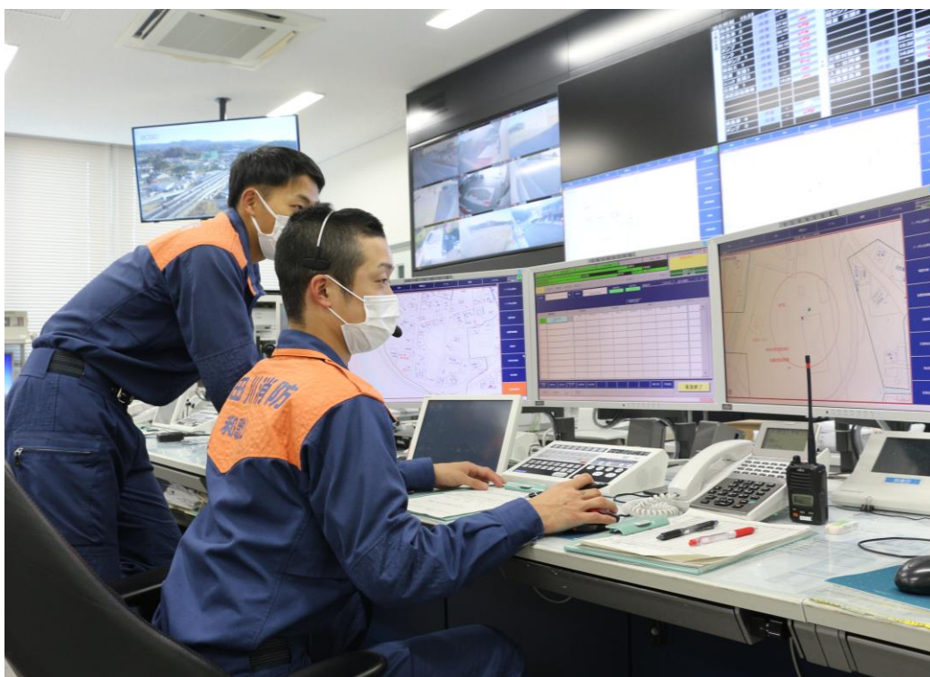
高機能消防指令システム
