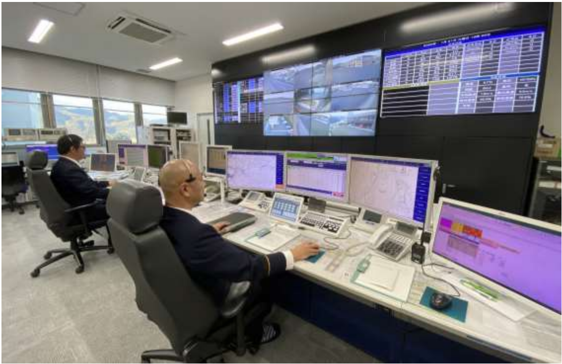
高機能消防指令システム
