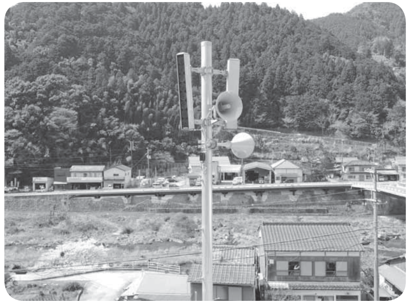
防災行政無線屋外スピーカー
