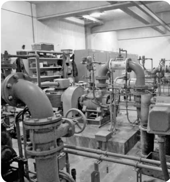
吉備浄水場施設（垣倉）
