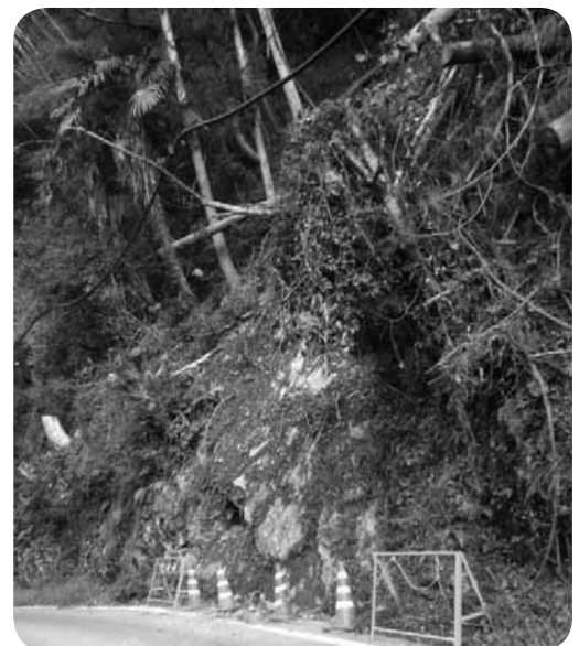
整備が遅れている危険な県道
