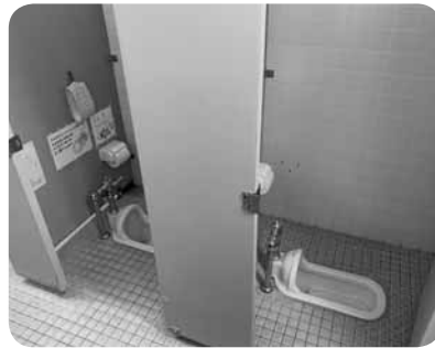
八幡小学校のトイレ（大規模改造予定）
