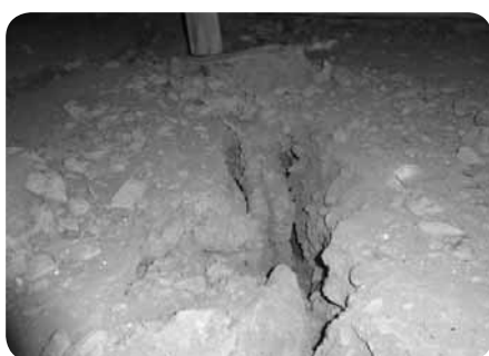
住居床下の地すべり状態
