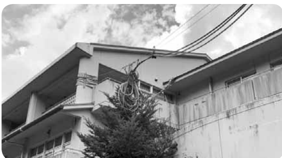
開閉器が故障し仮復旧中のしみず園（9月時点）
