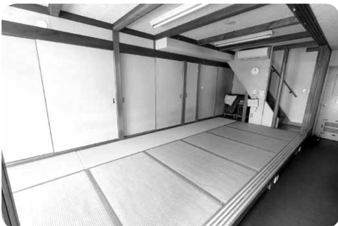
プライバシーが保たれていない仮眠室
