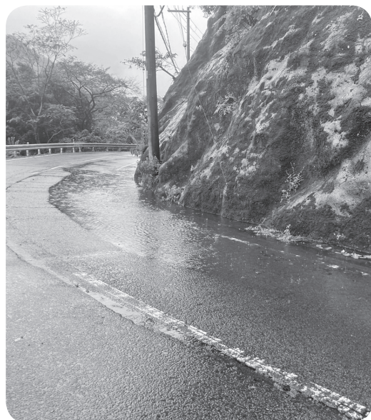
毎回溢れる側溝
