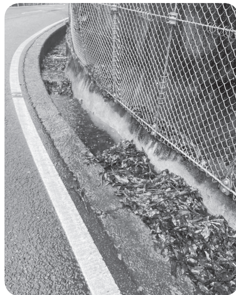
側溝が詰まって溢れる
