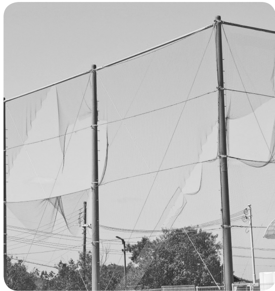
防球ネットの修繕が急がれる
