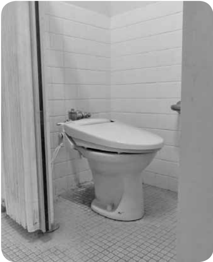
暖房便座が設置されたトイレ
