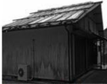
修繕が急がれる屋根(東大谷生活改善センター)
