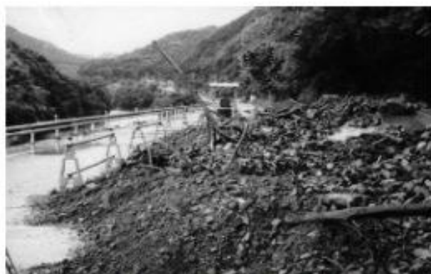
大雨で国道424号へ土砂が流出(吉原地区)
