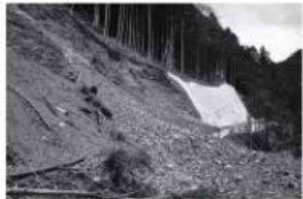
林道での災害現場
