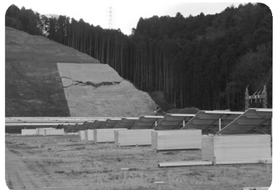
法面の吹付部に大きな亀裂(平成31年2月現在)
