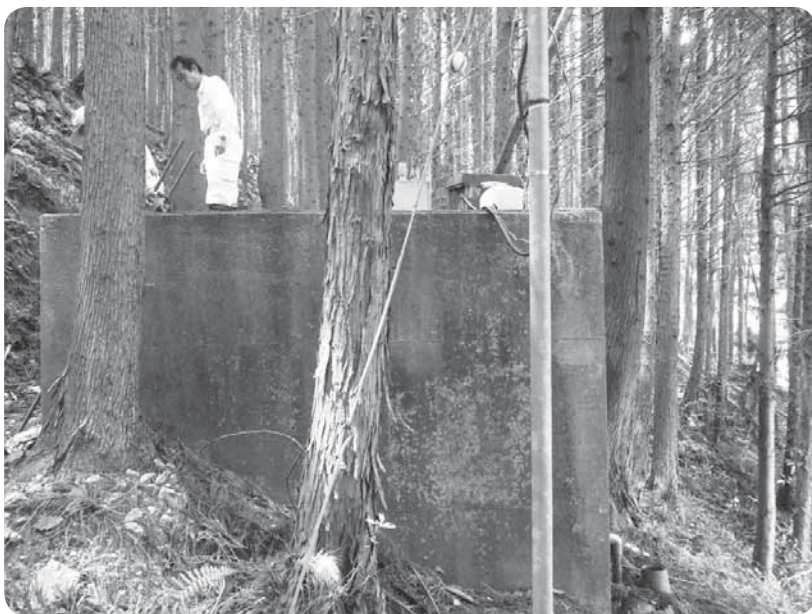
日物川飲料水供給施設配水タンク
