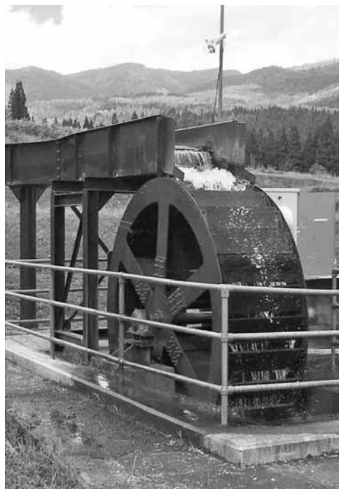
石徹白地区の小水力発電施設
