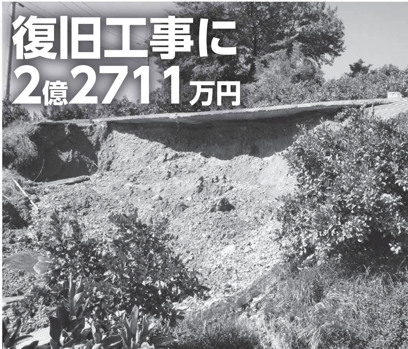
町道田角大賀畑線 災害箇所
