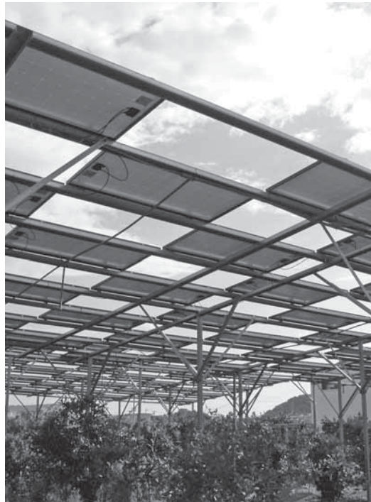
営農と発電を目的とした営農太陽光発電施設（上中島地内）
