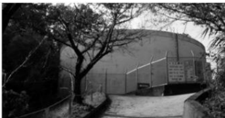
老朽化した配水タンク (五郷地区)
