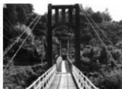
老朽化した平野橋(川口地区)
