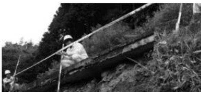
町道も危険箇所が多い
