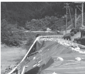
台風18号による国道480号久野原地内の崩壊
