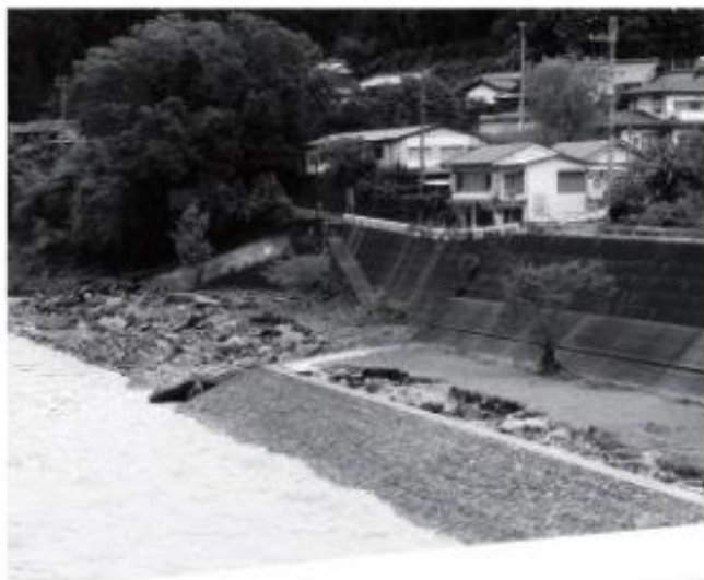
河川堤が割られた二川河川公園(二川地内)
