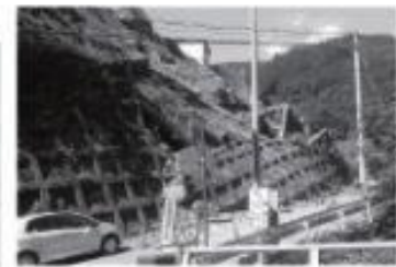
通行止めになっている町道(沼地内)
