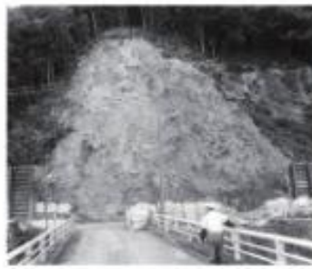
国道480号災害現場(川口地内)
