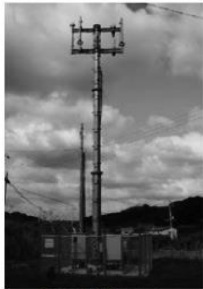
移動用通信鉄塔(長谷川地内)
