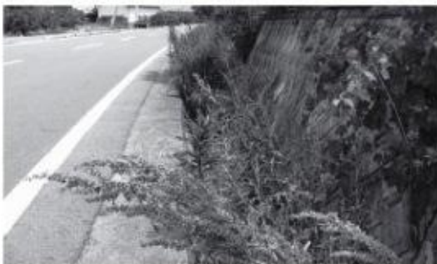
草木が生い茂った側溝
