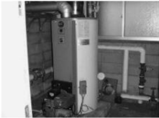
暖房用給湯ボイラー
