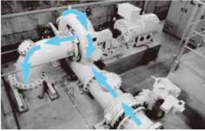
小水力発電所内にある水車と発電機。 矢印の方向に水を通すことで発電ができます。
